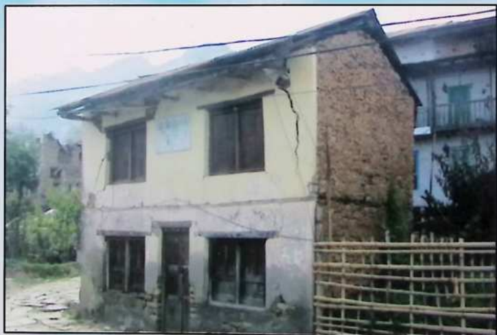
२०७२ सालको महाभूकम्पले क्षतिग्रस्त भवन ।
